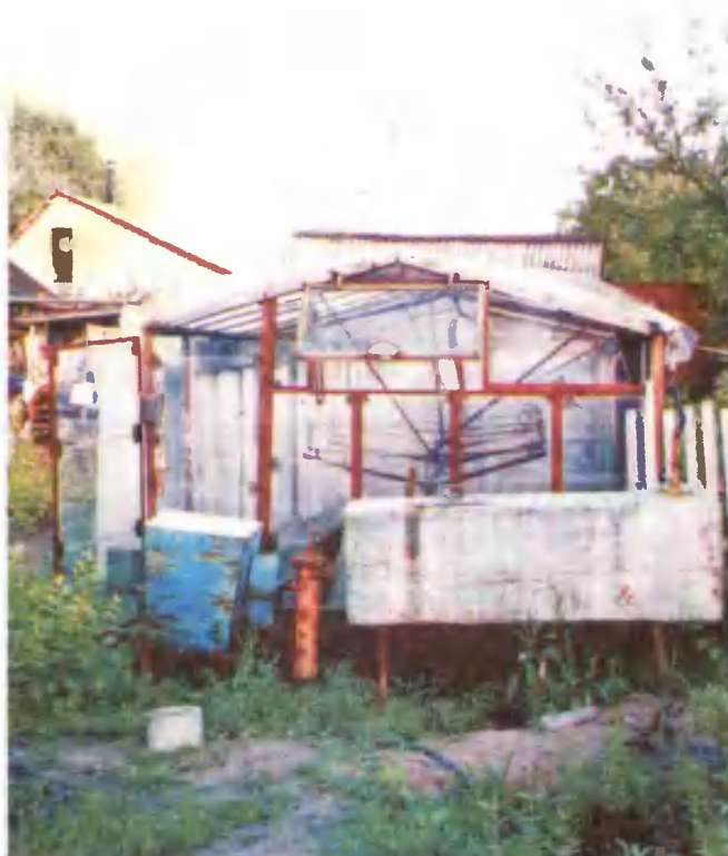
Общий вид установки. На переднем плане (слева — направо) бак для воды, фильтр и клапаны, плунжерный электронасос и щитовая с приборами.
